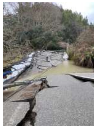
国道249号被災状況3
