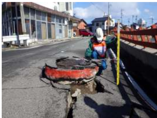
下水道施設(雨水渠)の被害状況3
