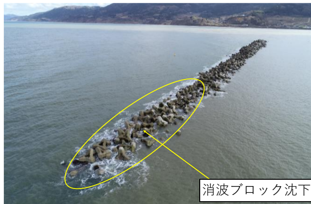
第6防波堤の被災状況 (令和6年1月9日撮影)
