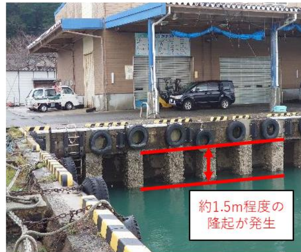
地震後の物揚場の状況 (令和6年1月9日撮影)
