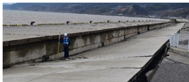
マリンタウン岸壁の被災状況 (令和6年1月10日撮影)
