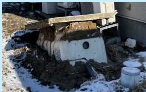
地震により浮き上がった浄化槽
