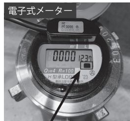
電子式メーター パイロットマークが点滅する。
