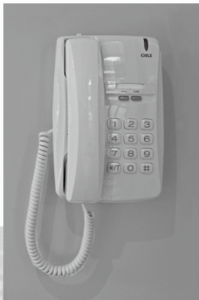
▲駆け込み通報装置
