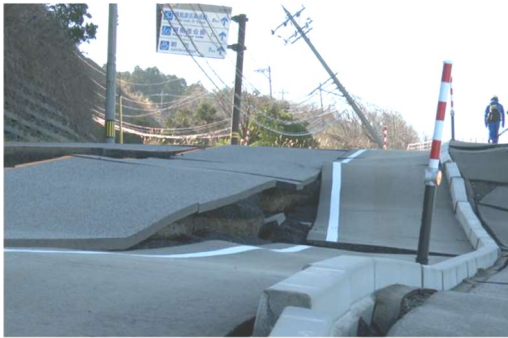
国道249号の道路崩壊
