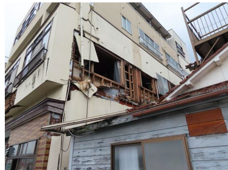
外壁の脱落被害〔市内〕
