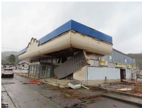
軒天井の落下被害〔市内〕
