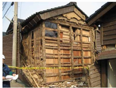
輪島塗の土蔵の被災状況〔河井町〕
