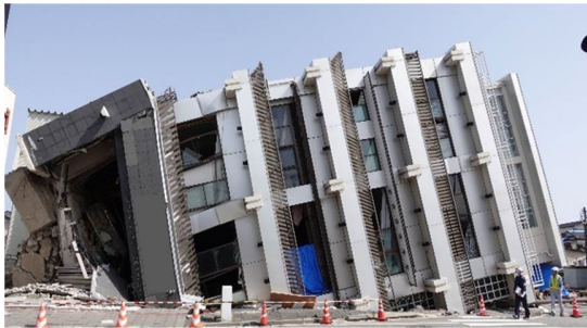
鉄筋コンクリート造建築物の転倒被害 〔河井町〕
