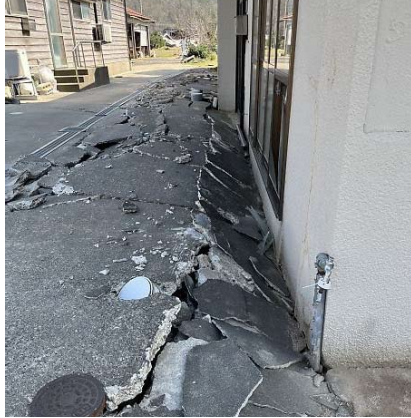
液状化により基礎が地中にめり込んだ建物 〔門前町道下〕
