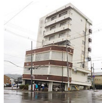
鉄筋コンクリート造建築物の 傾斜被害〔河井町〕
