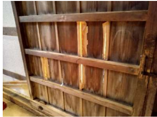
写真-52 板戸の破損
