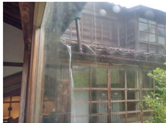
写真-51 雨樋の機能不良
