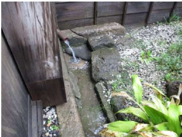
写真-59 側溝（柵蓋）の現状
