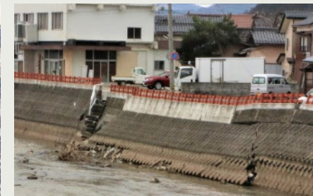
河川護岸の損壊
