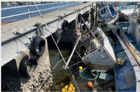
漁港施設の損壊
