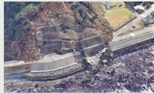
幹線道路の通行止め
