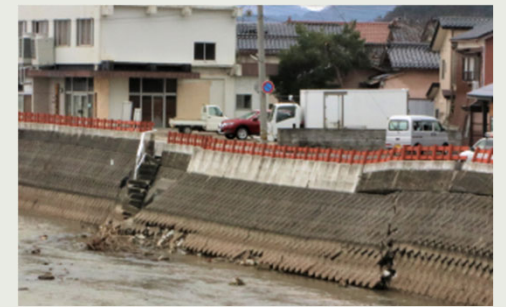
河川護岸の損壊
