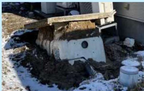
地震により浮き上がった浄化槽
