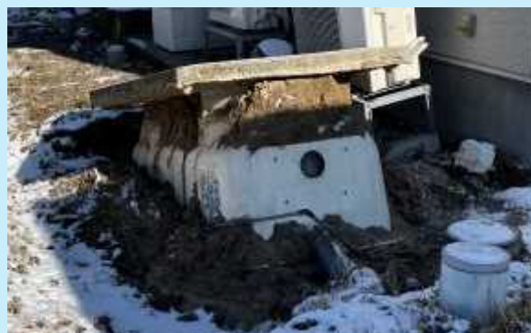
地震により浮き上がった浄化槽
